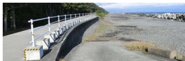
図-11 藤守川河口部に設置されている転落防止柵
