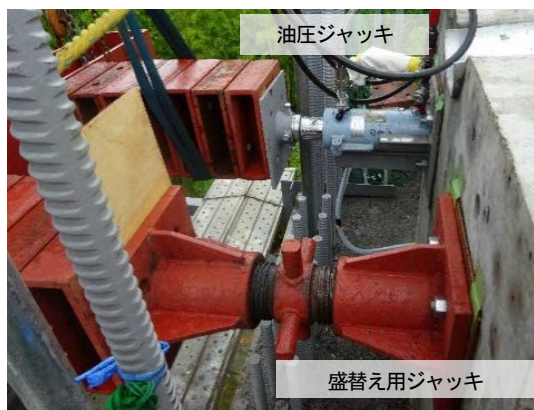
写真-2 1次ロアリング設備
