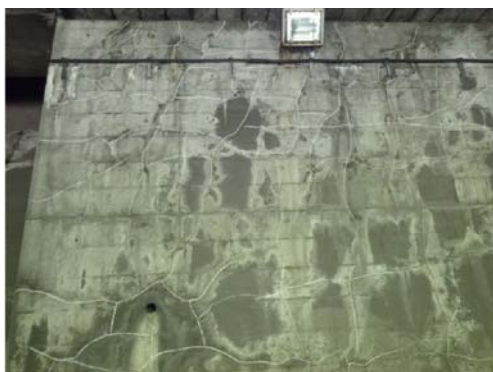
図 4-2 山側擁壁に発生した亀甲状のひび割れ (木地屋洞門-1-5 1982 年 1 月完成)
