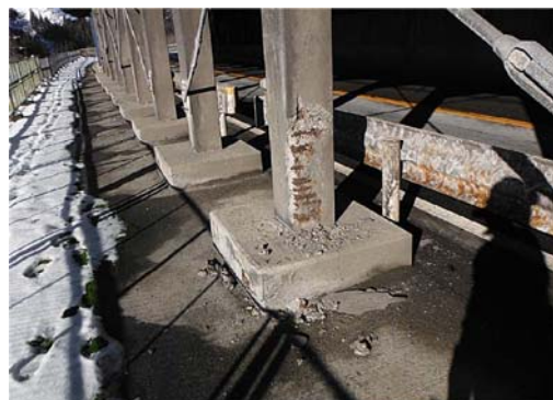
図 4-3 凍結防止剤の飛散により劣化した支柱 (東漆山洞門-5-1 1982 年 3 月完成)
