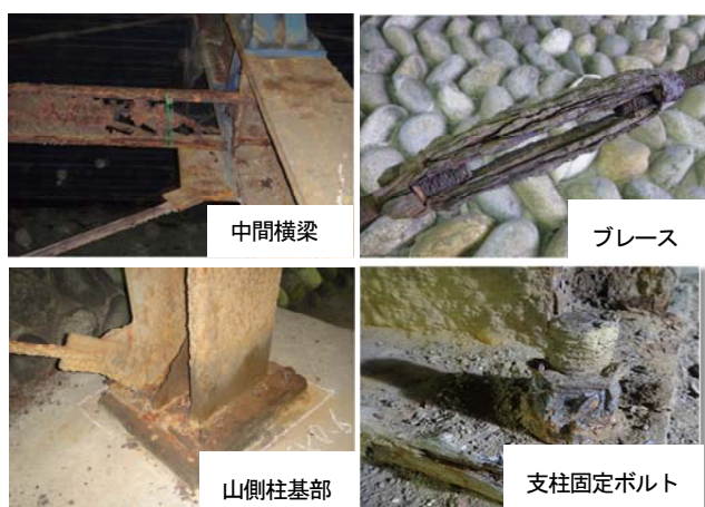
図 4-1 重度に腐食した鋼部材
