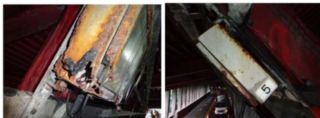
図 4-4 左写真：車両進行方向の照明カバー面 右写真： 上記と対面の照明カバー面
