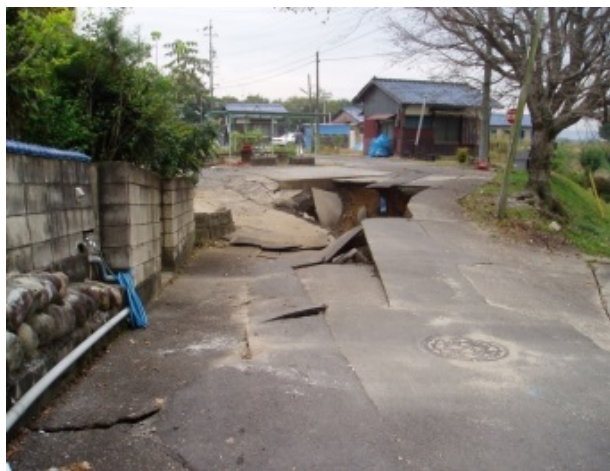
写真-2 御嵩町地盤沈下(平成22年10月20日)
