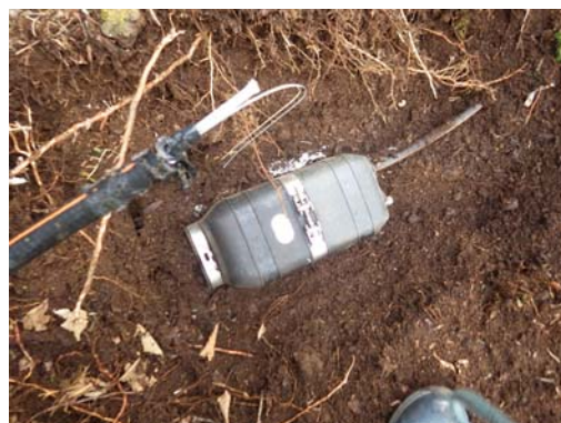
図-10 台風24号の影響でクロージャーから引き抜かれた光ファイバー
