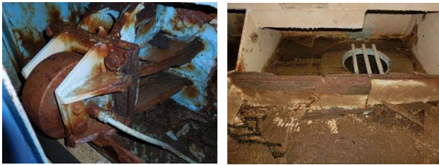
図-4 扉体の劣化状況写真
