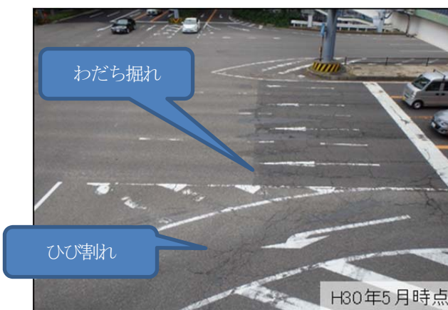
写真-1 舗装損傷状況
