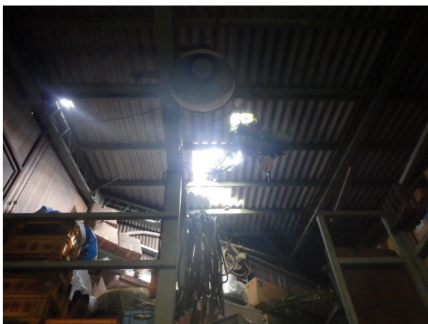
写真-1 事故発生時の屋根の損傷状況
