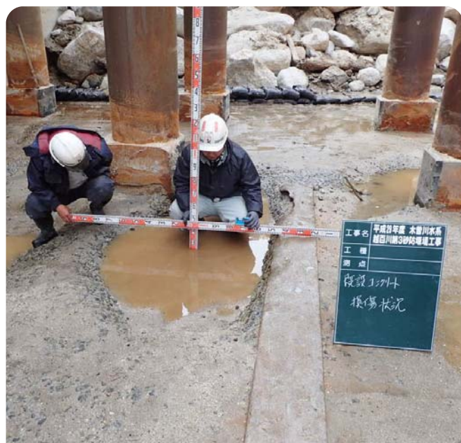
打設コンクリート(水叩き)損傷状況 下流側より
