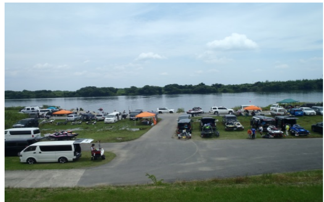
図-4 変形護岸の目的外使用(海津市海津町大和田)
