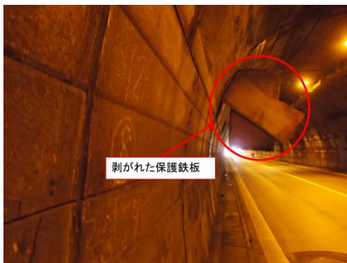
図4 トンネル内部（事故当日）
