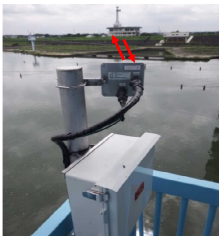
写真-6 無線LAN装置 (子局装置)
