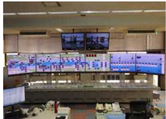
写真-1 管理所操作室
