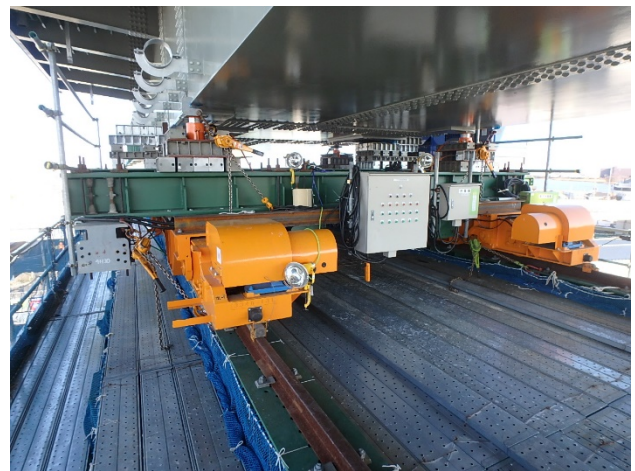
写真-2 自走台車設備
