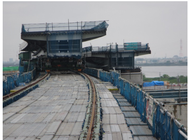
写真-1 軌条設備
