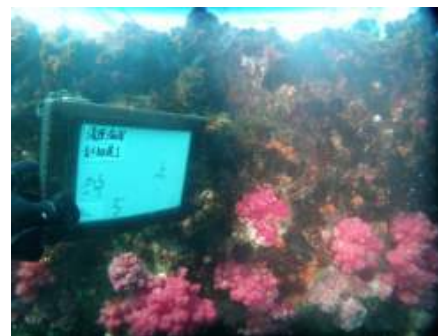
図-6 設置から数年が経過した離岸堤の状況
