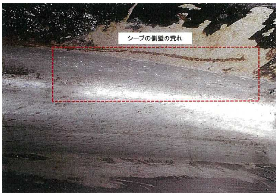
写真-4 5号シーブ溝側壁の荒れ
