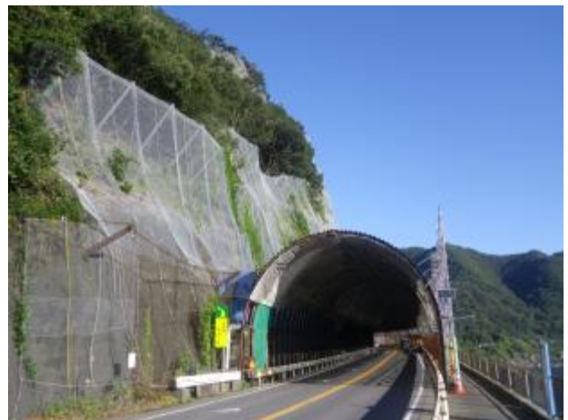
写真-8 ポケット式落石防止網工
