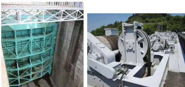
図-1 ゲート設備
