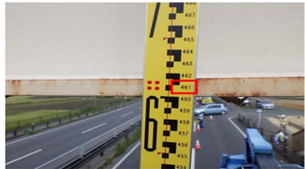
写真-4 損傷箇所の桁下高
