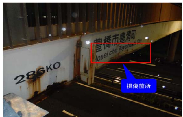
写真-1 豊清歩道橋 損傷箇所
