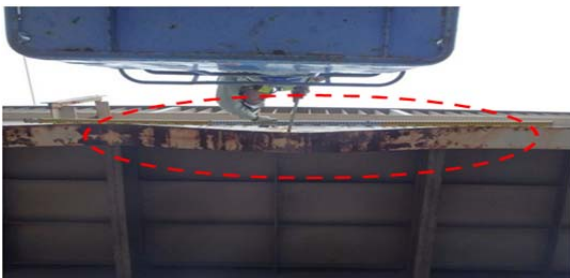
写真-2 主桁下フランジとウェブの変形
