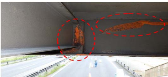
写真-3 垂直補剛材と横桁下フランジの溶接部の破断と塗膜の剥離
