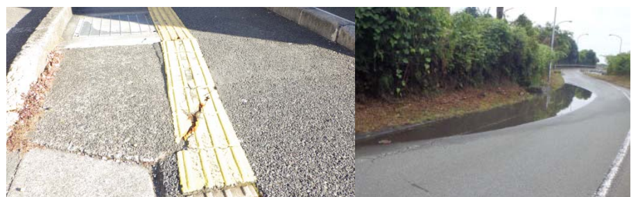
fig.4: 巡視ポイント一例(点字ブロック損傷と冠水箇所)
