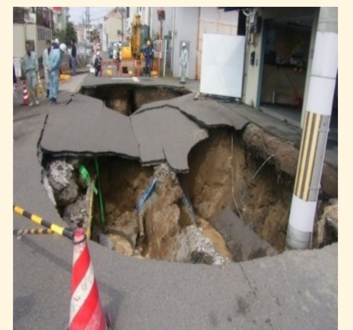
管きよの老朽化による道路陥没
