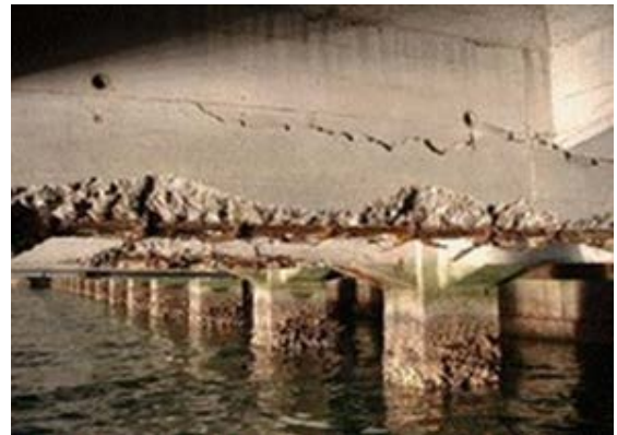
図-1 栈橋コンクリート下面の劣化状況
