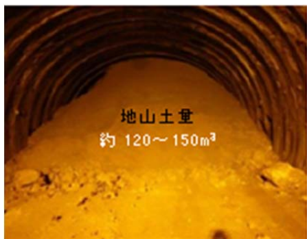
写真1 天端抜け落ち状況
