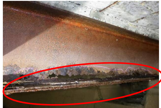
図-5 寿橋2（市）大浜街道線）損傷写真
