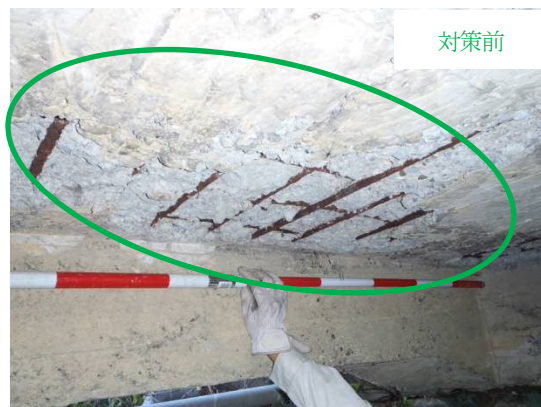
図-10 無名橋566（（市）興津本町11号線）損傷写真
