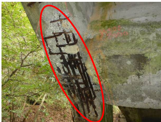
図-8 大畑橋（主）南アルプス公園線）損傷写真
