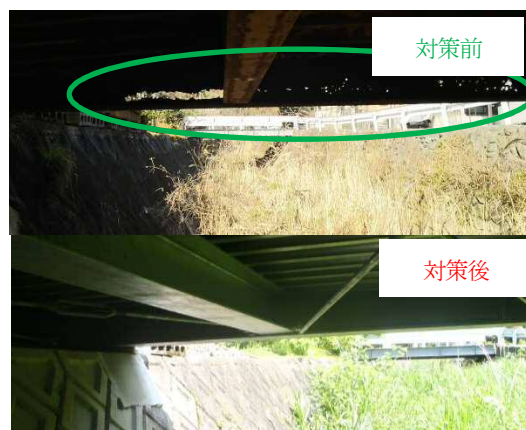
図-14 Ⅳ判定橋梁対策前後（損傷部拡大写真）
