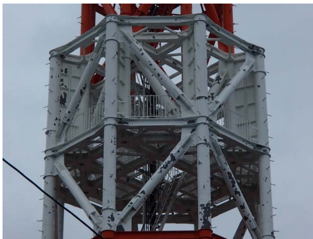
写真-2 白色塗装箇所の剥がれ状況（近景）
