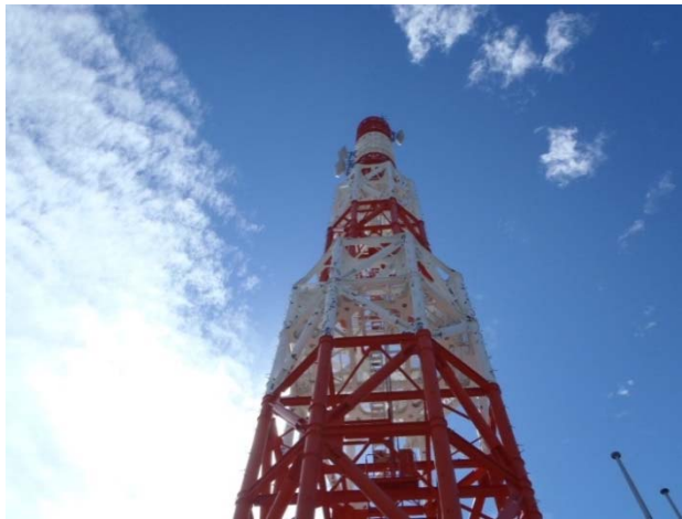
写真-1 白色塗装箇所の剥がれ状況（遠景）
