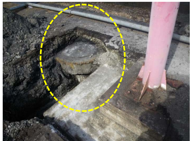
写真-5 埋め殺しにされたマンホール.
