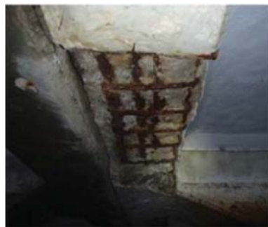
写真-2 床版梁部の劣化状況.
