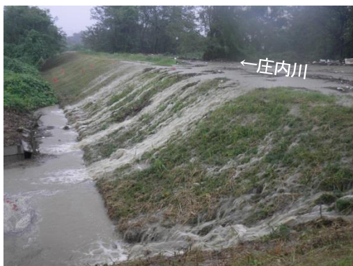
図-1 中流部における越水状況
