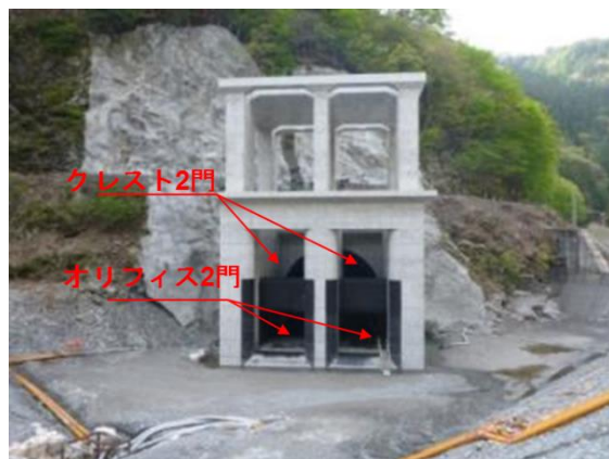
写-2 呑口正面写真
