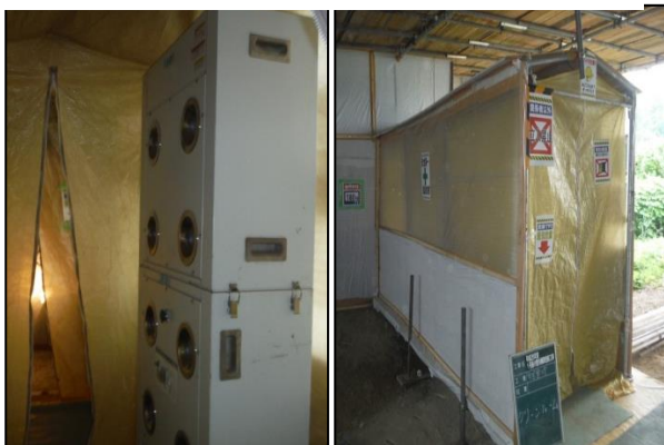
図-6 クリーンルーム・エアシャワーの設置状況
