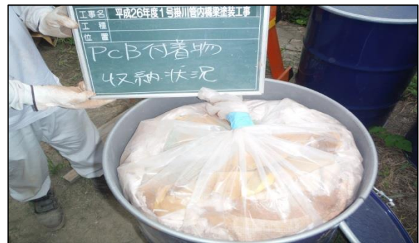
図-11 PCB廃棄物 保管状況
