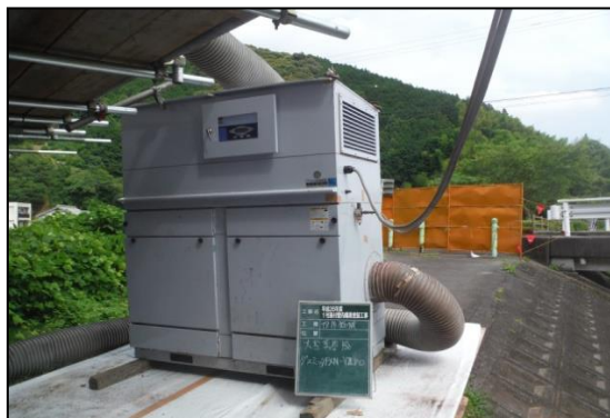
図-4 プッシュプル型換気装置設置状況
