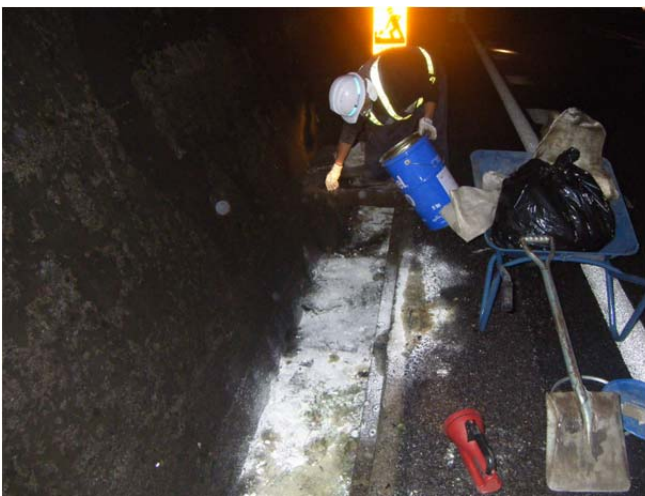
写真-2 事故後作業状況 (撮影:H22. 10. 28 午後11時頃)
