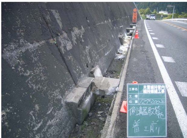
写真-3 道路損傷状況 (撮影:H22. 10. 29 午前8時頃)
