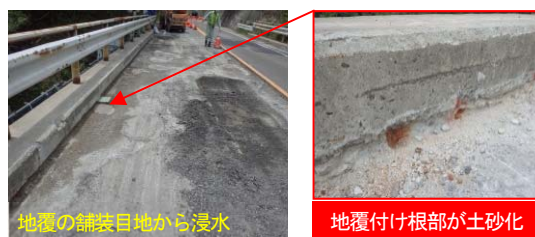
写真-12 舗装目地のコンクリート部材損傷状況
