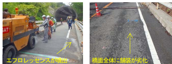
写真-4 応急復旧箇所後の再劣化状況
