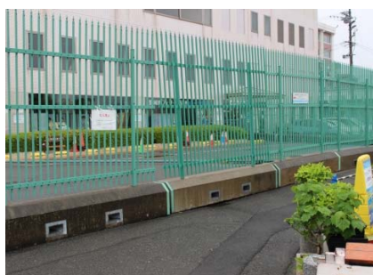
写真-4 可動式のSOLASフェンス。
