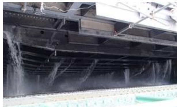
図-4-8 角落しの隙間からの水漏れ状況
