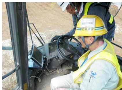
写真-4 システム動作確認
