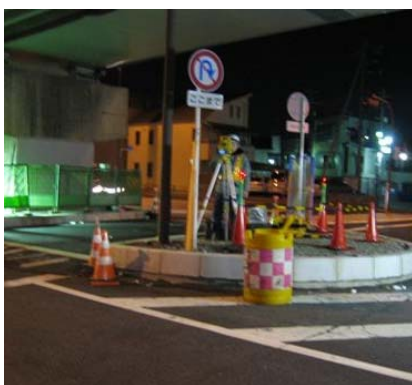
(b) TS本体の設置状況
