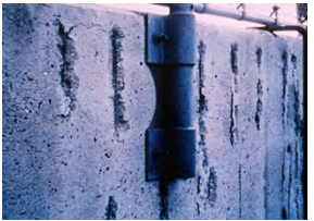
コンクリートのひび割れ
