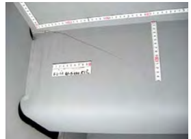
溶接部の疲労亀裂
