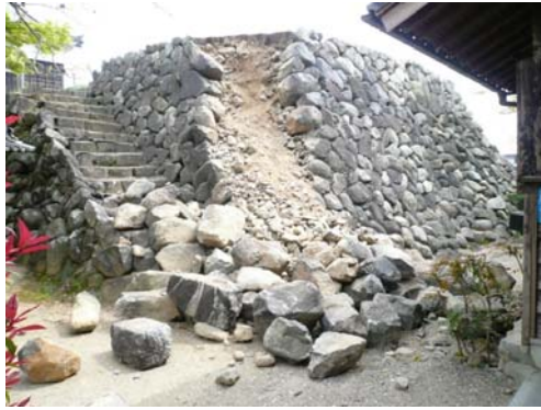
平成19年4月 地震により崩落した石垣
