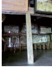
▲柱から見える建物の傾き
