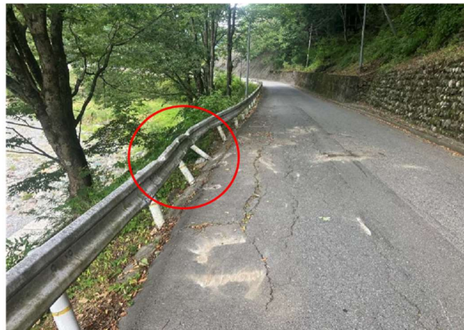
事故発生時の状況写真
