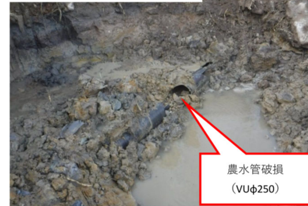
農水管破損状況（バルブ閉塞後）
