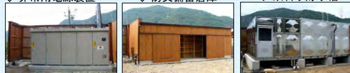
■ 防災拠点整備例 道の駅「美濃にわか茶屋」(岐阜県) ◇ 非常用電源装置 ◇ 防災備蓄倉庫 ◇ 飲料水貯水槽
