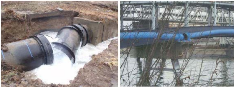
広域水道・工業用水の被害状況（東日本大震災） 出典:宮城県 HP
