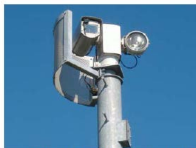
河川・道路等管理設備の点検 (CCTVカメラ・各種テレメータ等)
