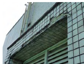
劣化した外壁の状況
