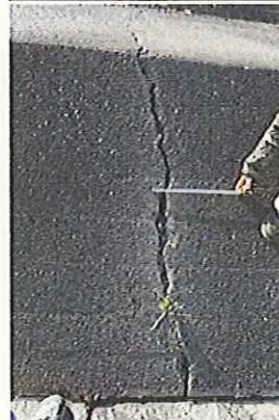
堤防損傷状況
