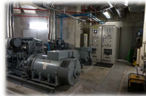
↑ 非常用発電機
