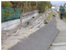
宅地の液状化被害
