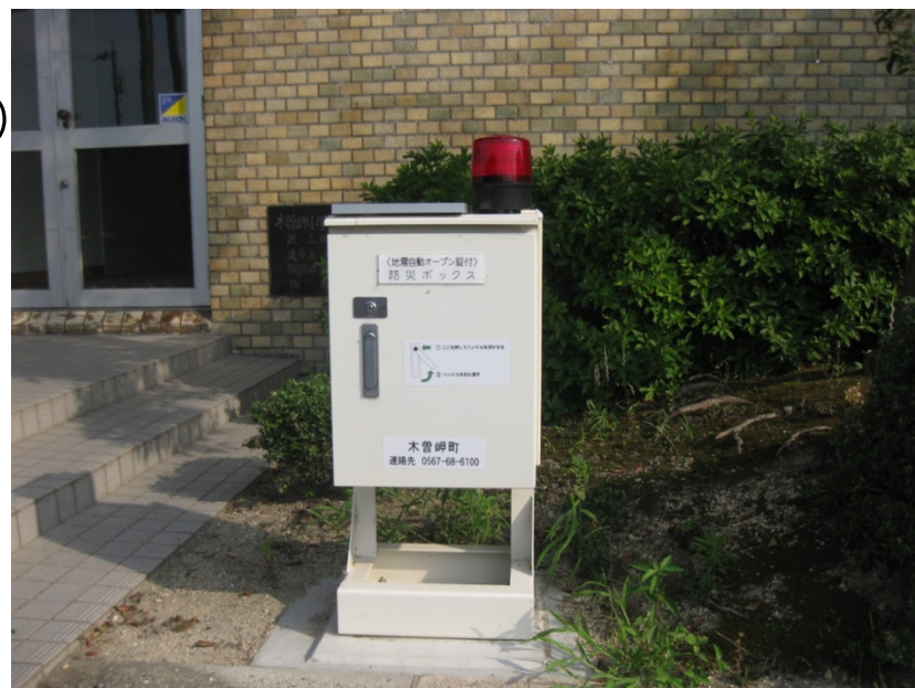
14箇所に設置された防災ボックス
