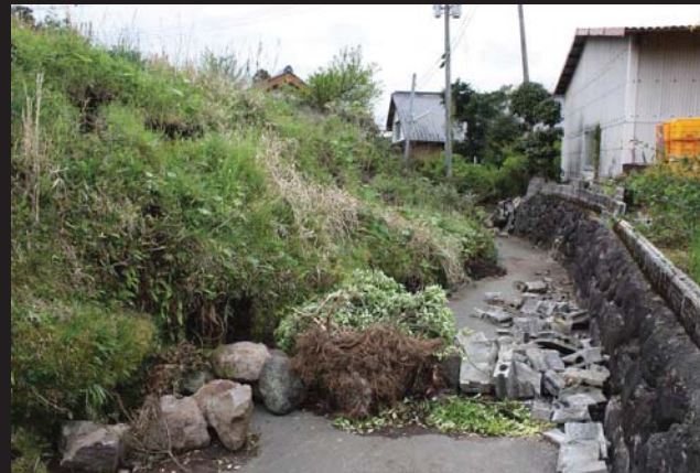
崩落により通行止めとなった村道
