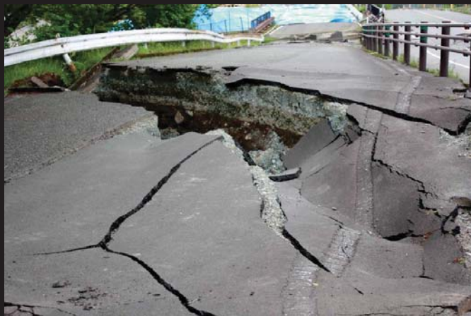
北向山断層 (大切畑ダム付近)
