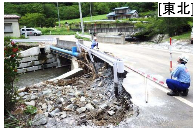
見内川地区の被災調査(岩泉町)
