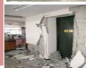
(※)東日本大震災後のA市役所の損傷状況
